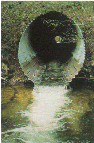
Photo 1 : Vue d'un débouché aval d'une buse illustrant les problèmes posés à la migration du poisson : chute à l'aval, vitesse élevée et tirant d'eau insuffisant dans l'ouvrage (Larinier, 1992b).
